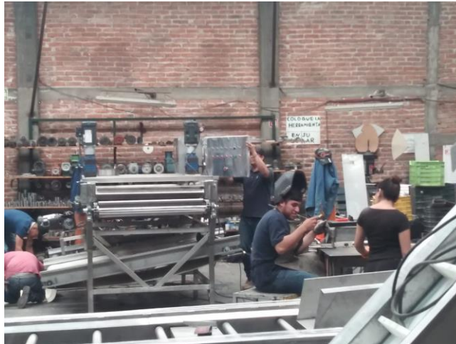
Ilustración 15 Falta de equipo de seguridad al maniobrar la maquinaria.
