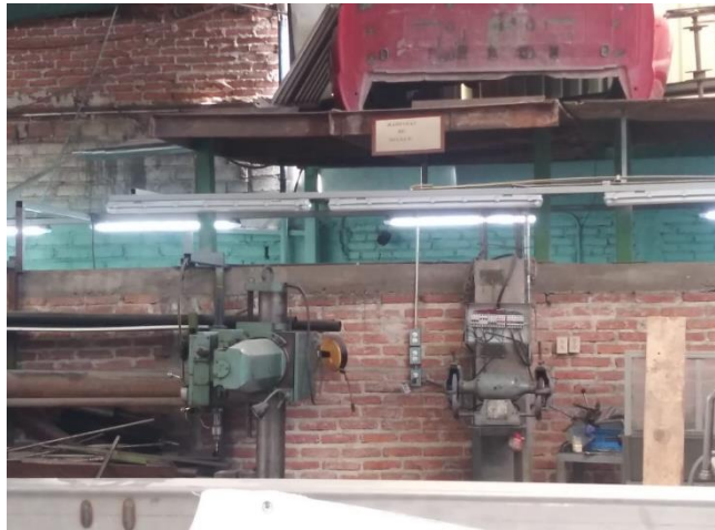
Ilustración 21 Falta de indicador de factor de riesgo.
